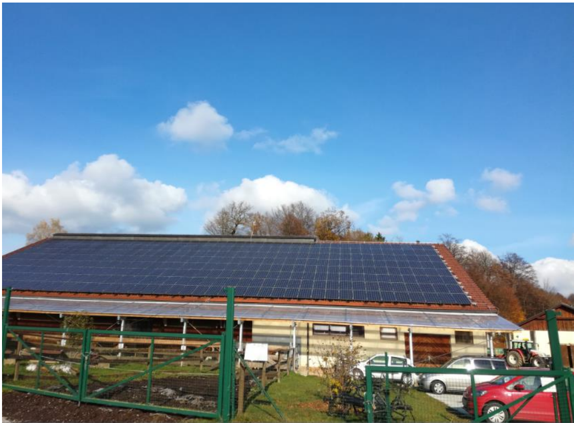
Sončna elektrarna Strahinj – fotonapetostni moduli na hlevu za govedo.
