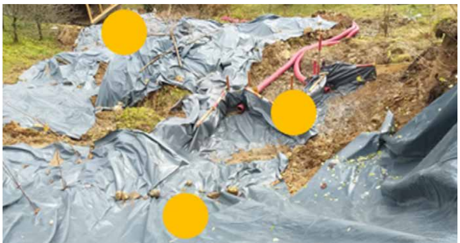
Slika 5: Detektirani pojavi izvirov (označeni z oranžno). Vidni so tudi prvi ukrepi preusmeritev dotokov površinskih voda na telo plazu, odvodnjavanje vod iz telesa plazu z drenažnimi cevmi, prekrivanje plazov s folijo za preprečevanje močenja plazine. Foto: J. Brodarič, 2020
