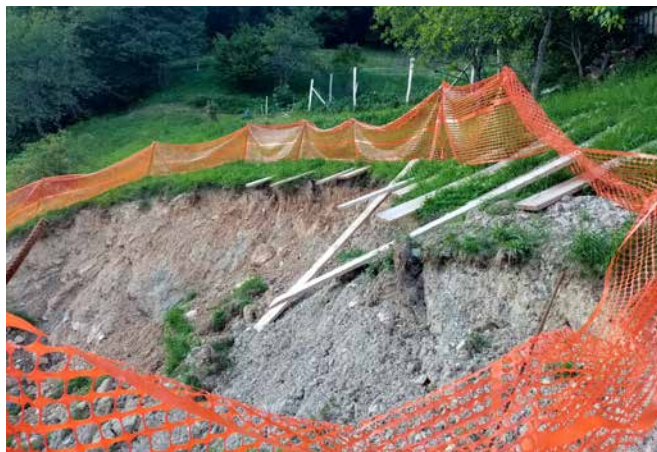
Slika 2.: Nekaj tednov pozneje. Nestrokovno delo, dopusti in dež so omogočili naravi, da ubere svojo pot. Nesprejeta gruščnata zemljina se je posipala, odlomne razpoke so bile vedno više po pobočju in so se že bližale zgornjemu objektu. Foto: F. Vidic, 2019
